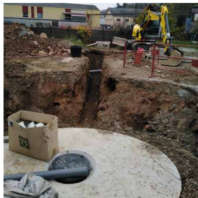
Cuve de 10 m 3
