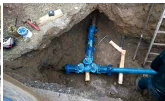
Pose de la vanne tri-directionnelle
